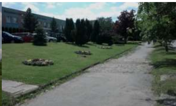
Fotografie: Zniszczony i wybrakowany ciąg pieszy przy ul. Księcia Józefa Poniatowskiego, w bezpośrednim sąsiedztwie Mazowieckiego Szpitala Wojewódzkiego
